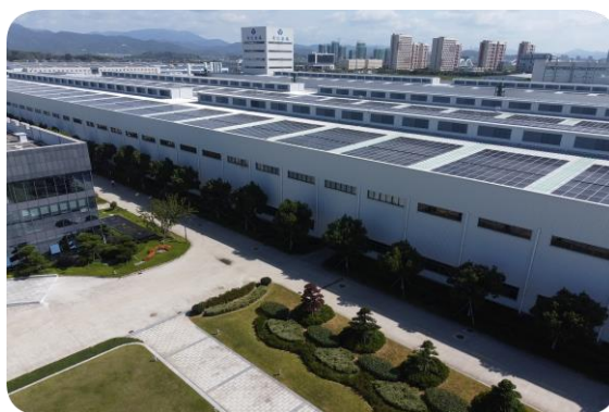
奇億屋頂太陽能板建置
