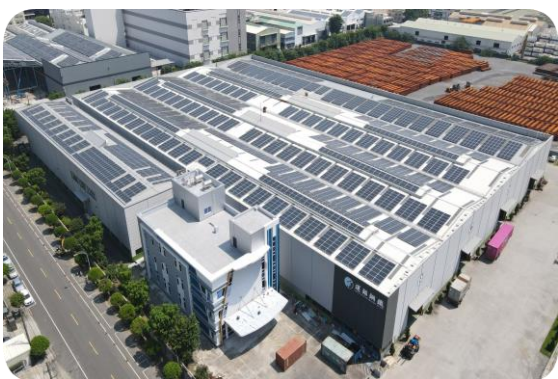
大發廠屋頂太陽能板建置
